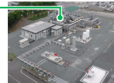
パイロットプラント全景 (JERA新名古屋発電所内)
