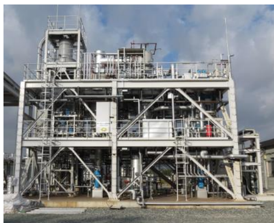
バイオマスガス設備
