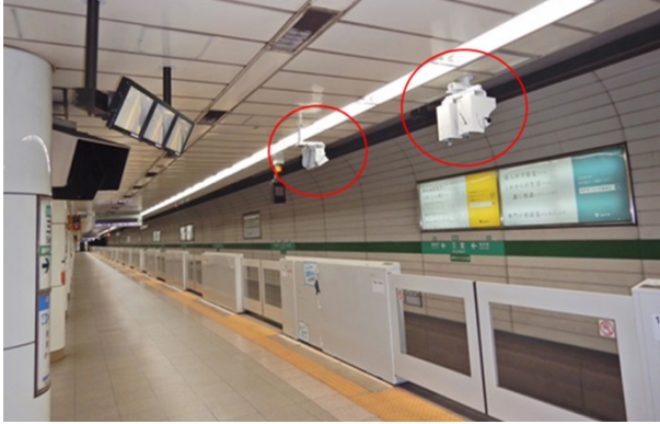
図4 三宮駅 地上完結型連携システムのセンサ取付け状況
