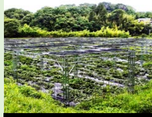
宝塚すみれ発電所の外観
