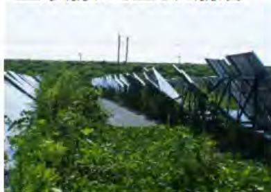
放置されたパネルの現況
