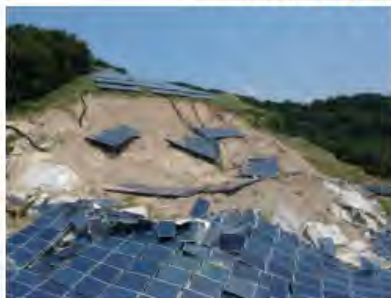
土砂崩れで生じた崩落
