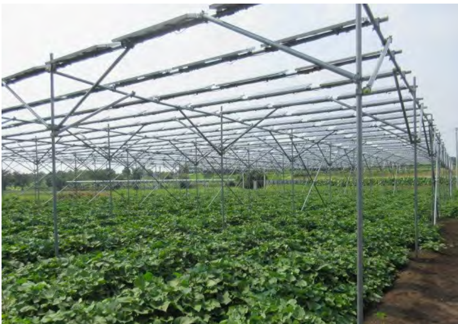
露地の畑の上部にパネルを設置
