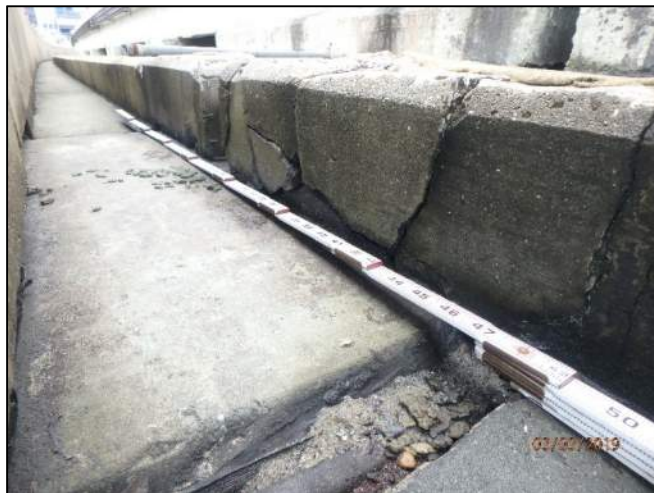
Second Pour Delaminations Above Pier 38
