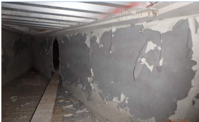
Span 31S: Peeling Paint Exposing Primer
