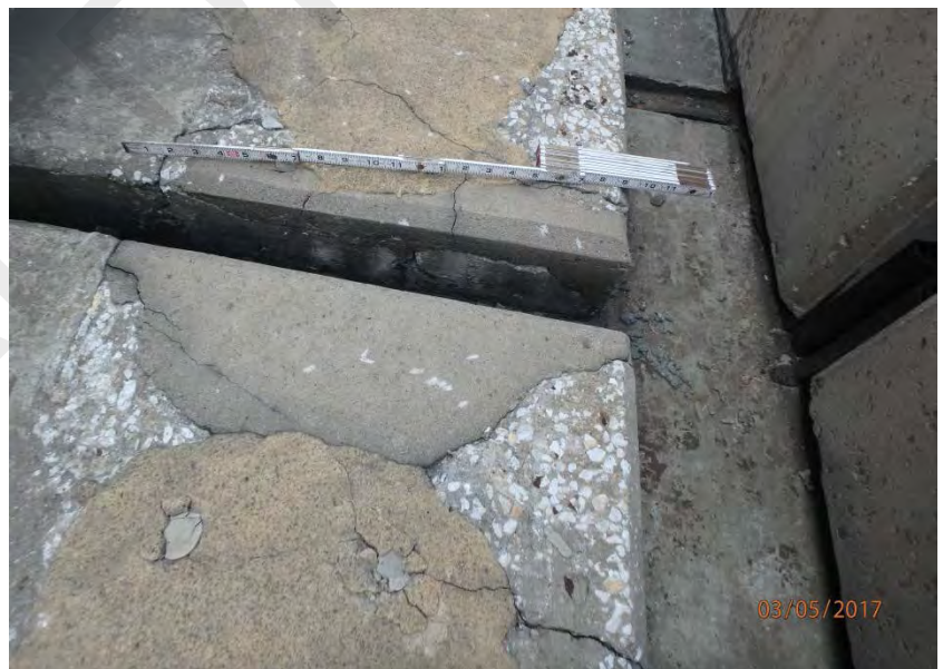
Second Pour Delaminations Above Pier 38
