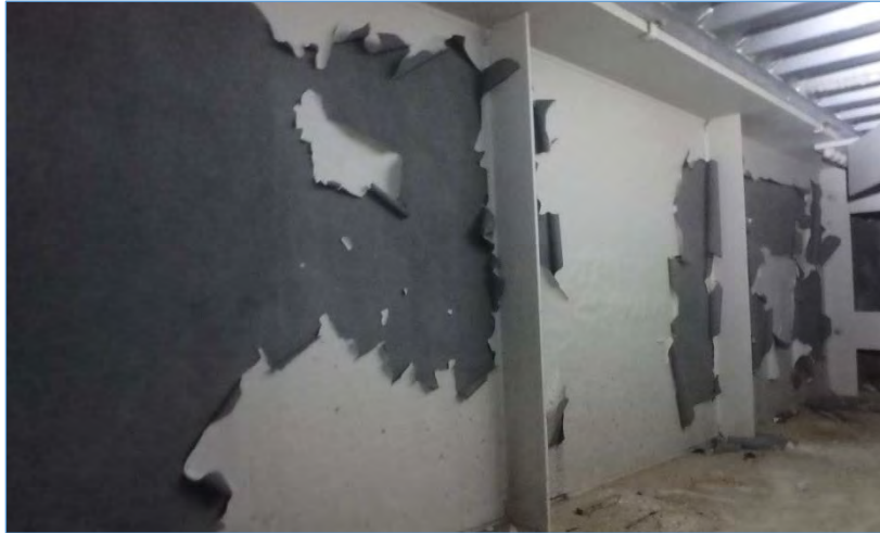
Span 9N: Peeling Paint Exposing Primer
