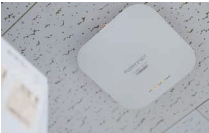
天井に設置されたアクセスポイント
