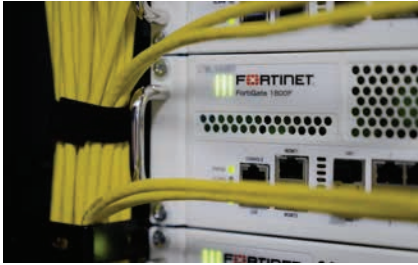
サーバールームで稼働するFortiGate 1800F
