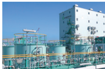
バイオジェット・ディーゼル燃料製造実証プラント
