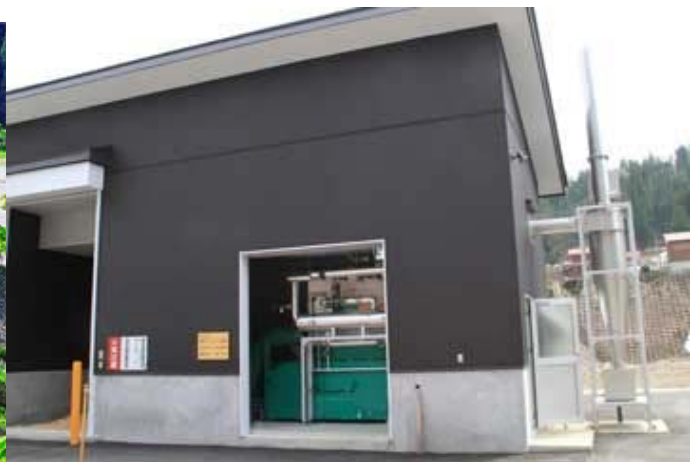
図2) バイオマスボイラー
