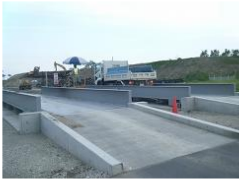
搬入場の状況（トラックスケール）
