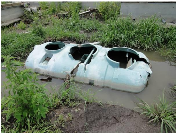
被災した浄化槽の写真
