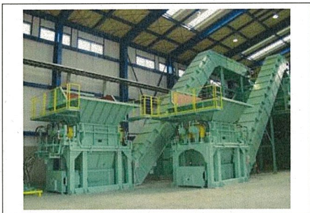
図 4-3 破砕機の屋内設置の例
