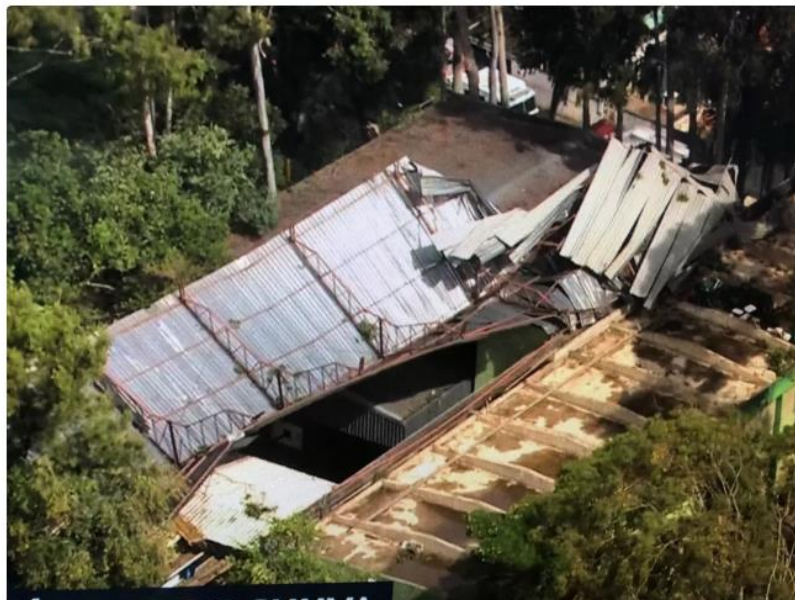
Chuva forte com rajadas de vento destelharam imóveis na Zona Oeste (Foto: Reprodução/TV Globo)
