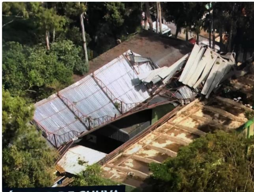
Chuva forte com rajadas de vento destelharam imóveis na Zona Oeste (Foto: Reprodução/TV Globo)
