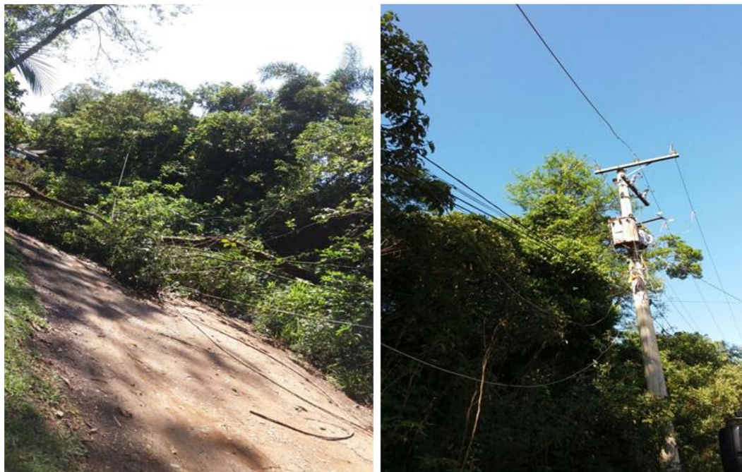
Queda de uma árvore de grande porte sobre a rede deixando fio de alta tensão Partido na Estrada da Capuava Circuito: COT 0114
