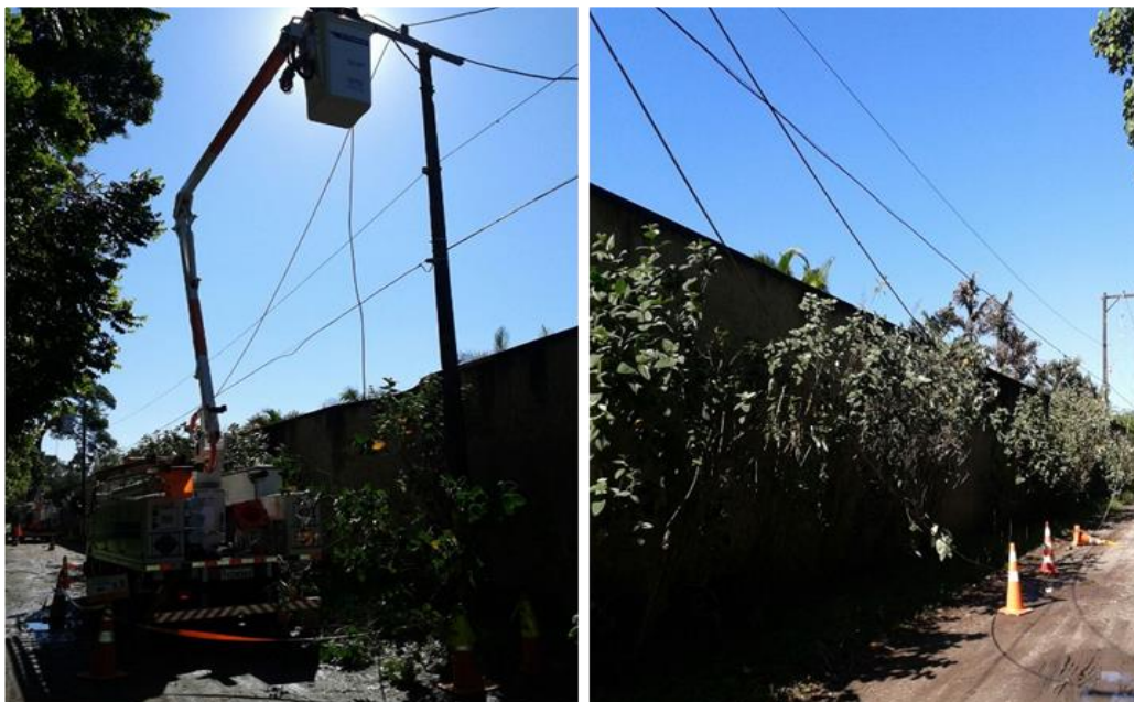
Queda de uma árvore de grande porte sobre a rede deixando fio de alta tensão partido na Estrada Municipal Vergueiro Circuito: EGU 0105
