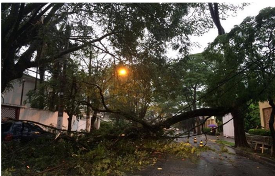
Queda de uma árvore de grande porte sobre a rede deixando fio de alta tensão Partido na Rua Pirandello Circuito: CAA 108
