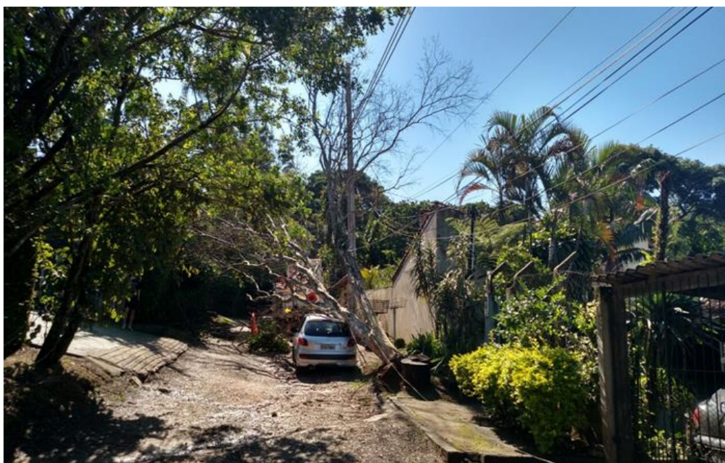
Queda de uma árvore de grande porte sobre a rede deixando fio de alta tensão Partido na Via das Orquídeas, Condomínio Colibri. Circuito: COT 0114
