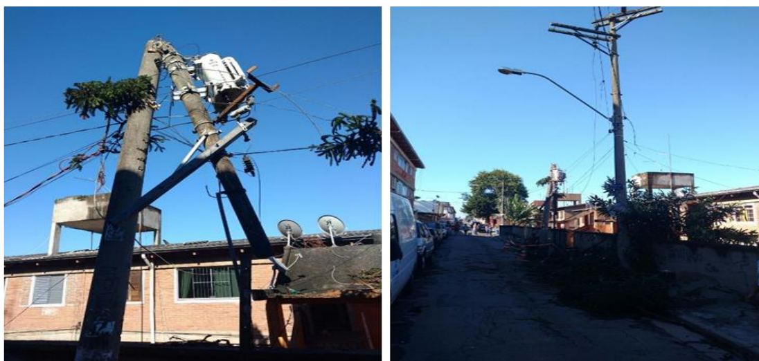
Queda de uma árvore de grande porte sobre a rede deixando fio de alta tensão partido na Rua Rio Grande do Sul Circuito: CPI 0110.
