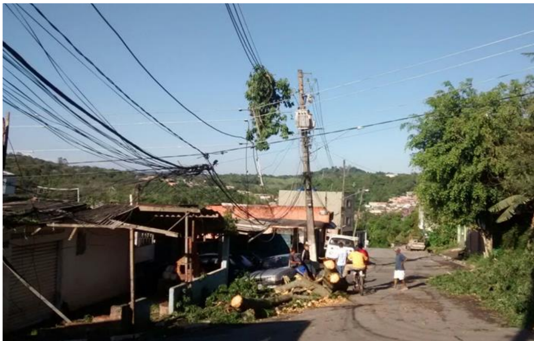
Queda de uma árvore de grande porte sobre a rede deixando fio de alta tensão Partido na Rua São Pedro Circuito: EGU 0105
