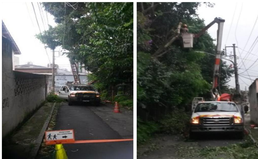
Queda de uma árvore de grande porte sobre a rede deixando fio de alta tensão partido na Rua João Alves Coelho, 2 Mooca - São Paulo CLA-0110
