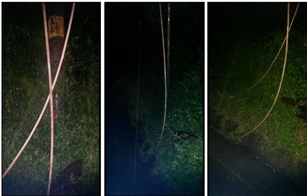
Queda de uma árvore de grande porte sobre a rede deixando fio de alta tensão partido na Av Francisco Monteiro 2000 Centro - Ribeirão Pires.
