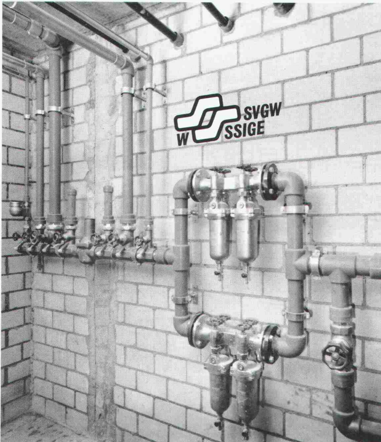
Verteilerbatterie in der Mövenpick-Raststätte «Heidiland» bei Sargans
