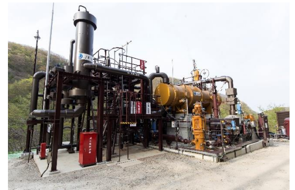
バイナリー発電設備
