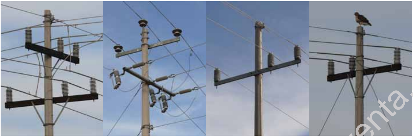
Figura 7. Estructuras de distribución eléctrica en el área de Janos. a) Poste tangente trifásico de concreto con cruceta de metal, b) Poste tangente trifásico de concreto con cruceta de madera, c) Terminal doble con puentes sin aislar y crucetas de metal, d) Terminal doble con puentes sin aislar con crucetas de madera. Fotos: Rodrigo Sierra Corona.
