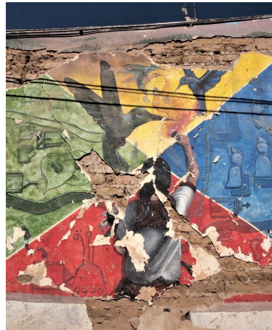
Mural destruido por el sismo.
