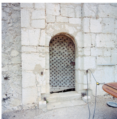
Détail du guichet piéton de la porte Marine M ; vantail d'origine et corbeaux. Phot. Marc Heller IVR93_20060600294XE
