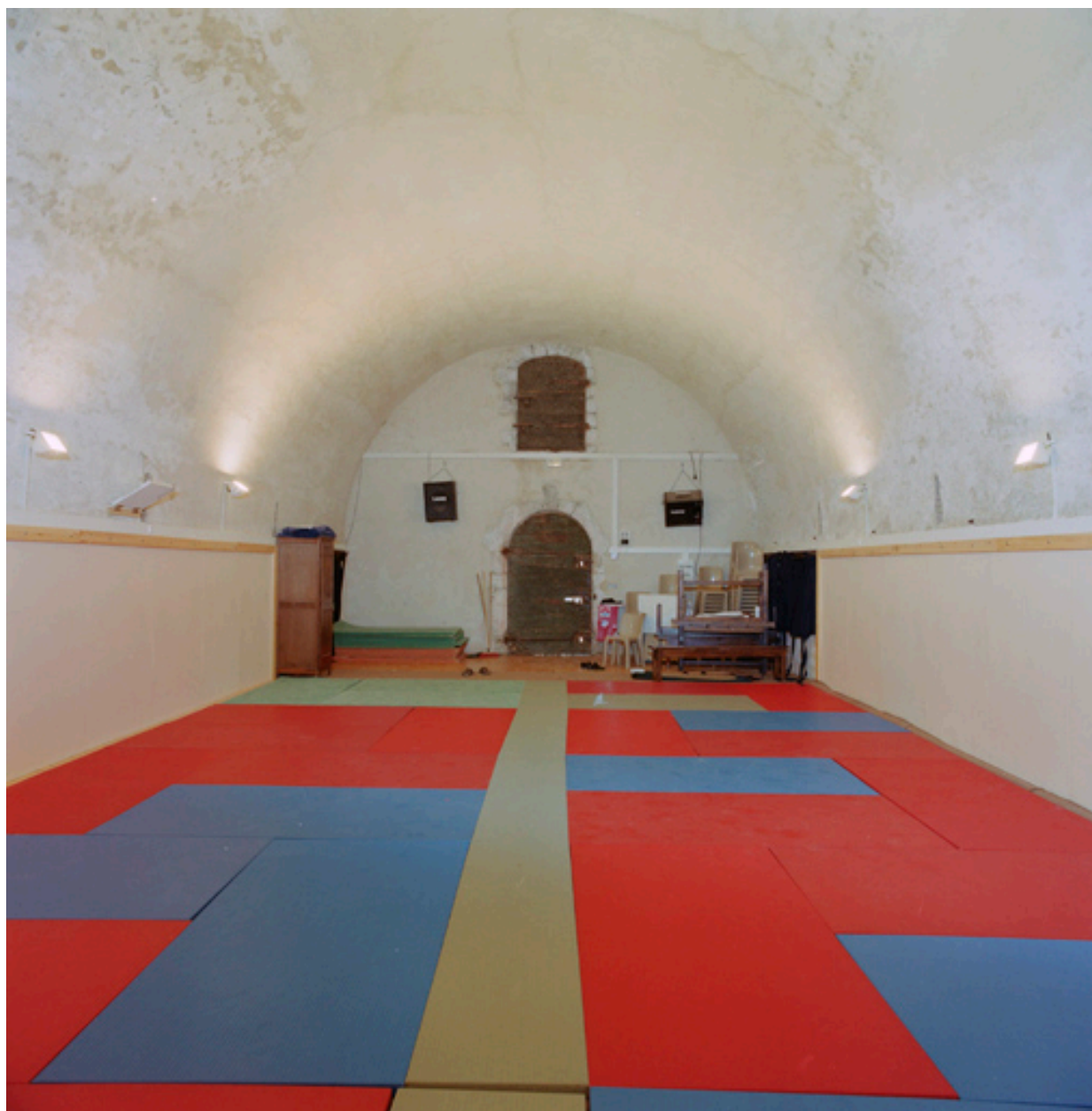
Salle intérieure du magasin à poudres R, vers le revers du mur pignon d'entrée.
