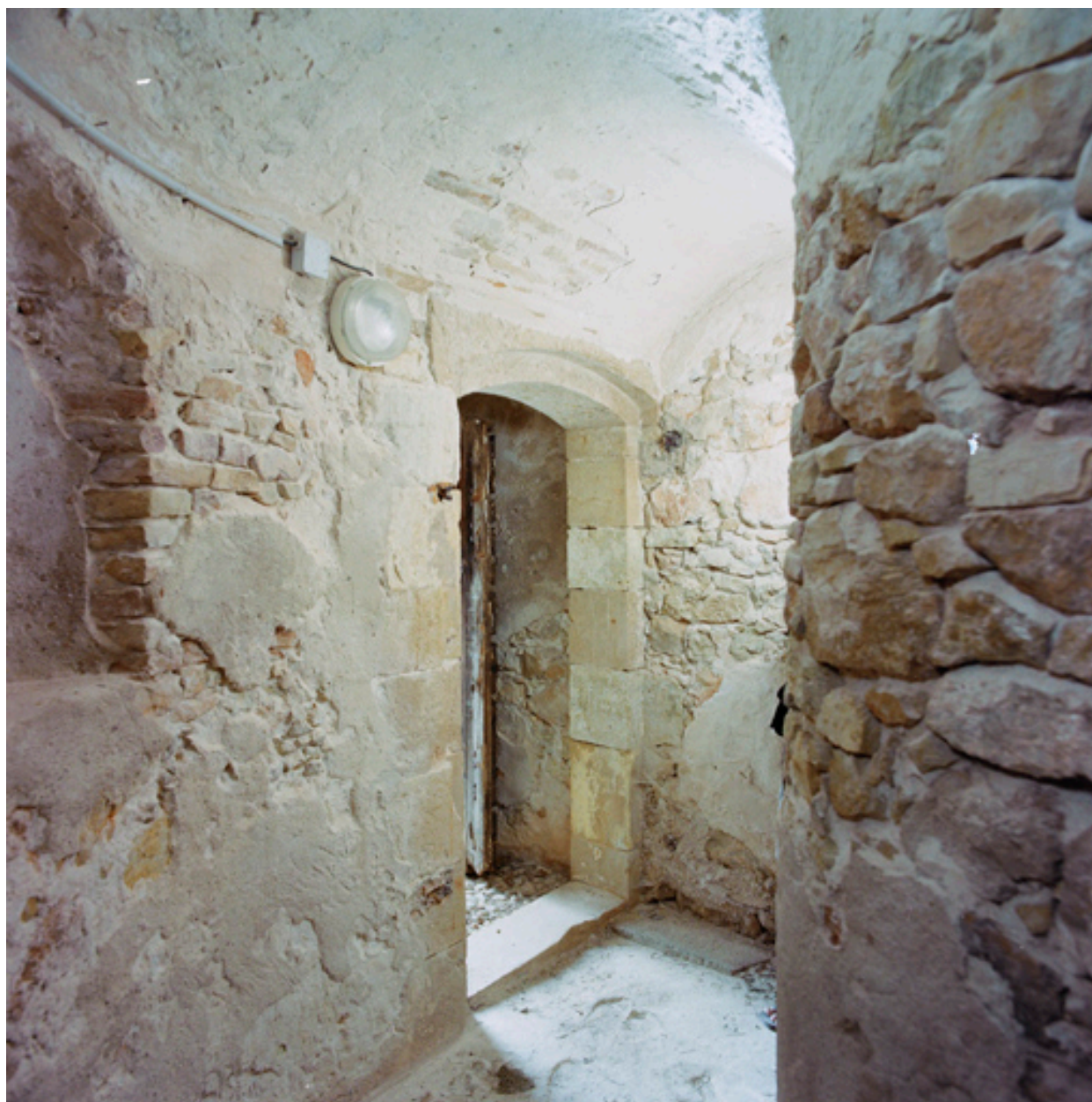
Couloir en chicane de la poterne sous l'abri voûté de l'ancienne porte royale p.
