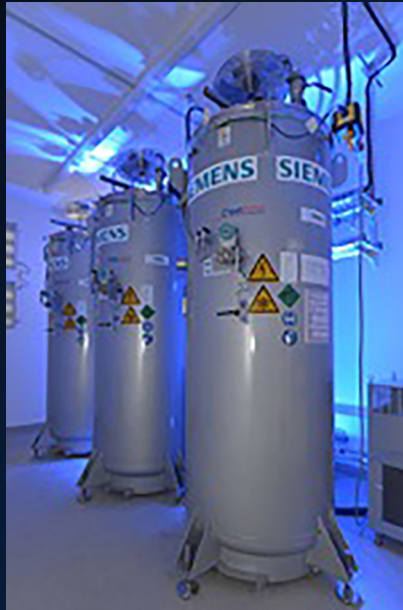
Stadtwerke Augsburg, Siemens
