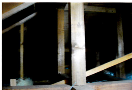
天井裏には断熱材が敷き詰めてあったが、屋根板には断熱材なし。夏熱いわけだ
