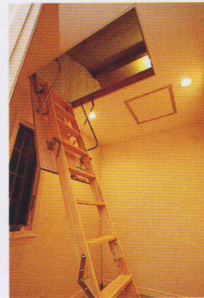
↑ 松下電工製の跳ね上げ式階段。新しく開口部を設けて設置する。右の点検口から覗いた工事前が左下
